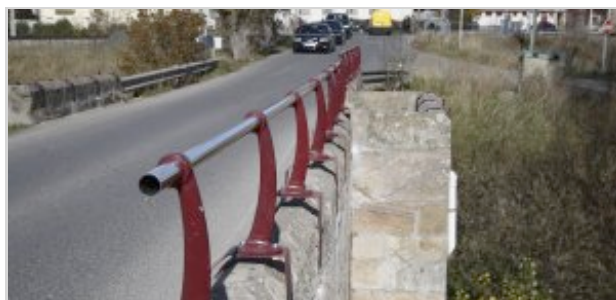
La barandilla de acero ya ha sido instalada sobre el puente de Matamorosa. :: J. L. SARDINA
